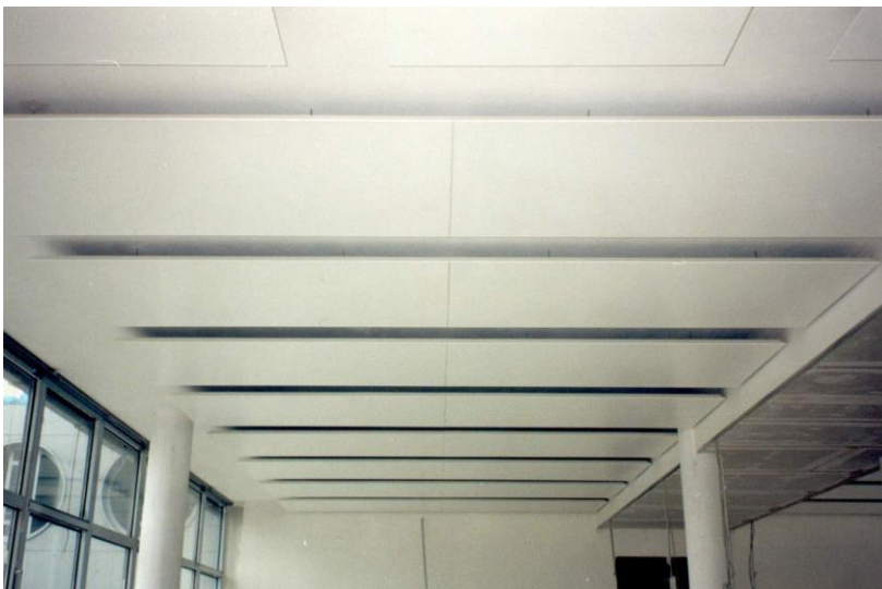
Heiz- und Kühlsegel peCool® - 75 DS Stahl
